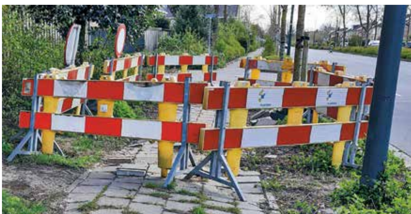
Sinkhole op de Vallestep blijft nog steeds een sinkhole
