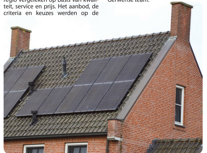
Een set van twaalf zonnepanelen levert al aardig wat energie op... Foto Cees van Keulen
