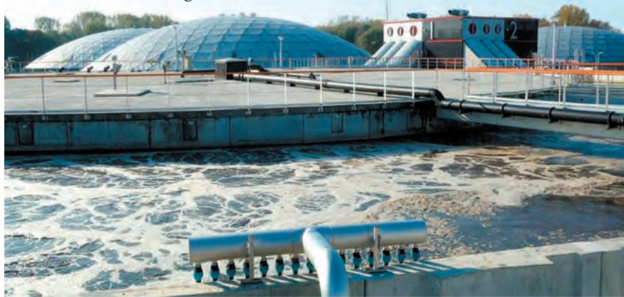
De rioolwaterzuivering in Eindhoven.
